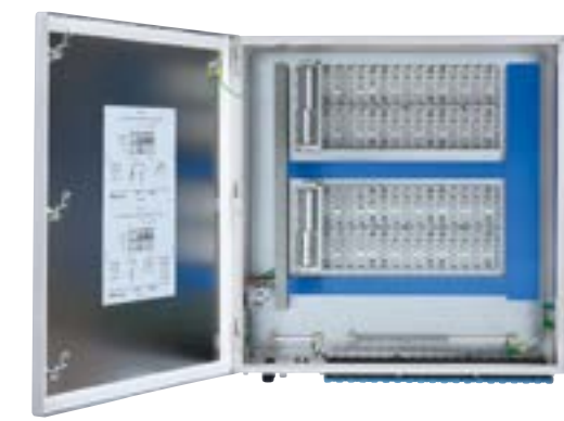
1718 Ex I/O avec châssis de 40 logements
