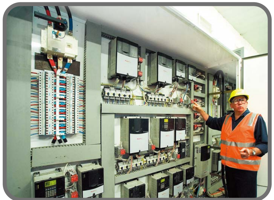
19台の可変周波数ドライブのそれぞれに採用されたアレン・ブラドリーのPowerFlex 70 AC ‘DriveGuard’がいかに人件費と占有スペースの削減に貢献しているかを説明するSmorgon Steelプロジェクトの電気系現場監督のWayne Pearse氏
